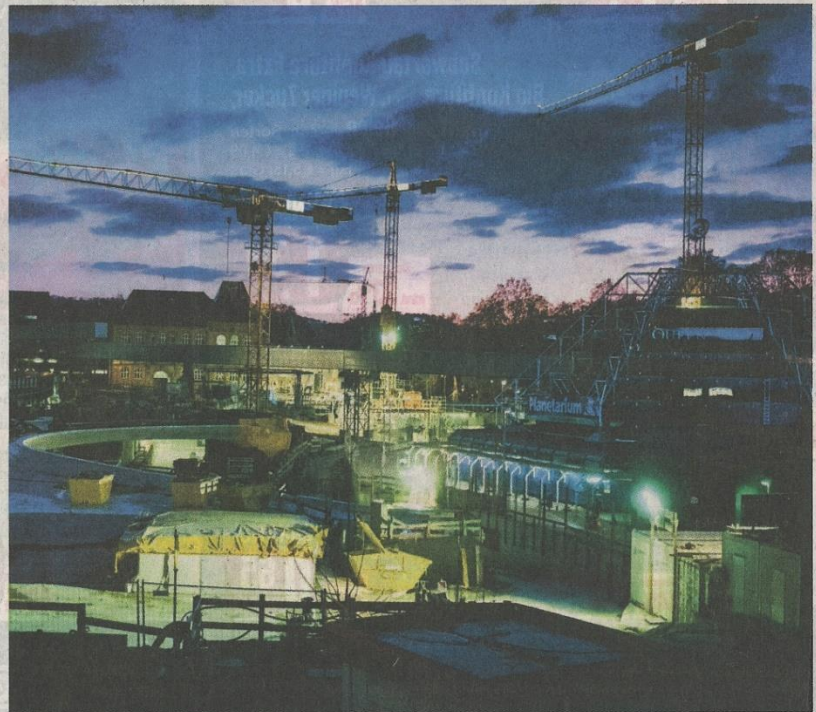
Trotz Baustelle war das Planetarium Publikumsbeliebter bei Kultur für alle. Foto: Lg/Zweygarth
